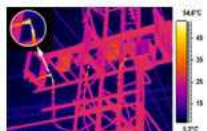
Échauffement des raccords sur chacune des phases
