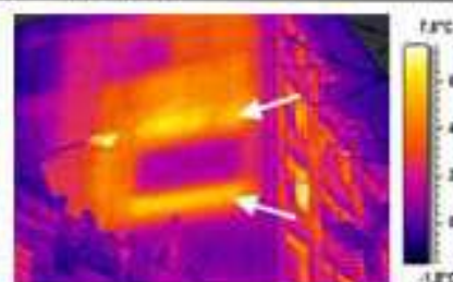
Importante perte de chaleur sur le mur extérieur
