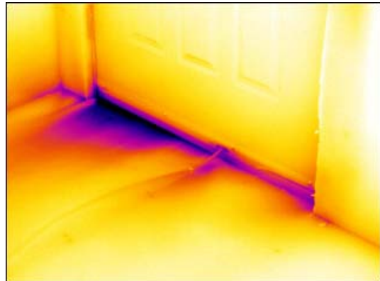
Figure 8.2 Infiltration d'air par un seuil non étanche
